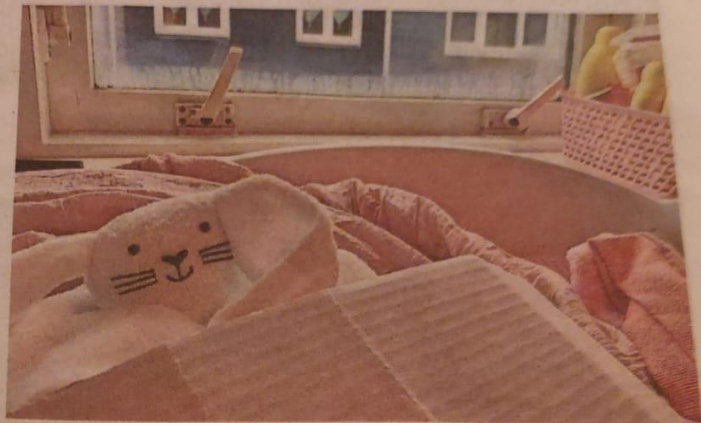
Schimmel bij het raam in een babykamer in een Helderse schimmelhuurwoning.
