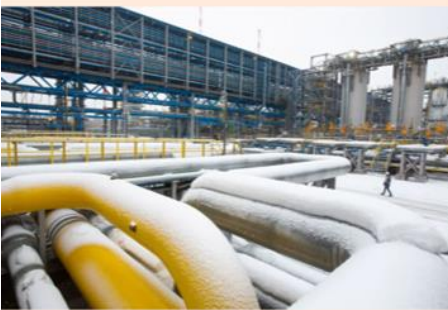
Compressorstation dat begin vormt van de gaspijplijn Nord Stream 2. Die moet de gastoevoer vanuit Rusland naar Europa vergroten. Mocht Rusland de gastoevoer stopzetten, dan is Nederland daar niet goed op voorbereid. Foto: Andrey Rudakov/Bloomberg
